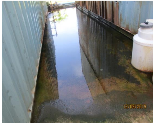
Eaux stagnantes non traitées.
