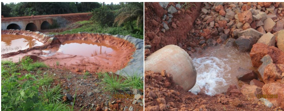
Bassins de décantation et l'eau décantée.
