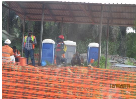
Des toilettes installées sur le pit 2.
