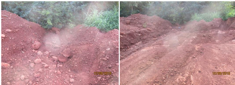
Des canaux sans bassin de décantation.
