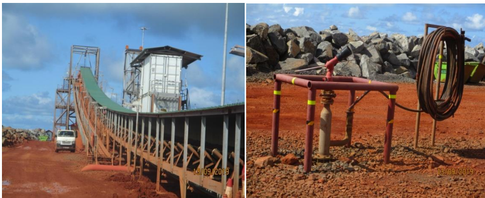
Des extincteurs et bouche d'incendie au port.
